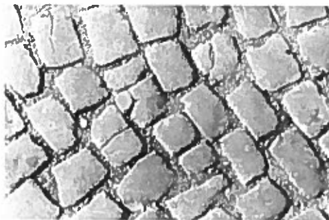
Rotunjirea pavelelor din uzură
