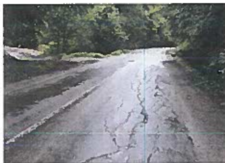
Rețele de fisuri și crăpături longitudinale
