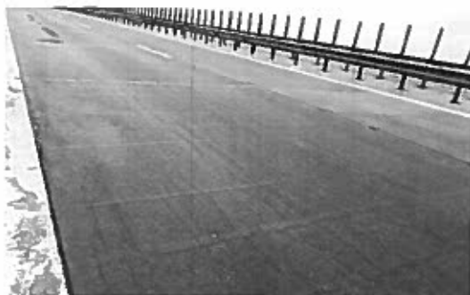
Fisuri și crăpături
