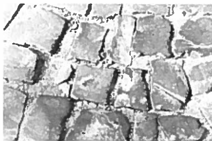
Înfundarea sau spargerea unor pavele izolate
