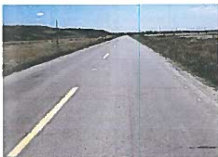
Fisuri transversale, ca urmare a transmiterii la suprafață a fisurilor de contracție din stratul de bază
