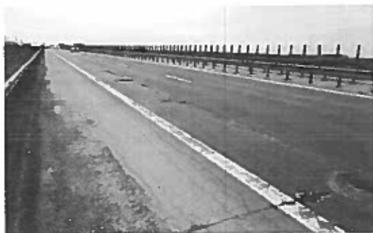
Suprafață exfoliată, cu fisuri și gropi
