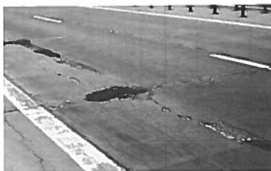
Gropi remediate cu mixtură asfaltică, degradate
