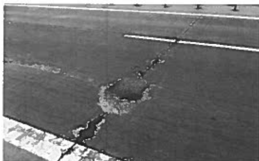
Rosturi cu mastic în exces
